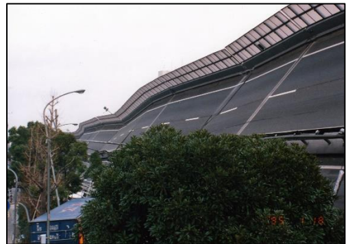
深江本町阪神高速 倒壊現場 (写真提供：神戸市)
