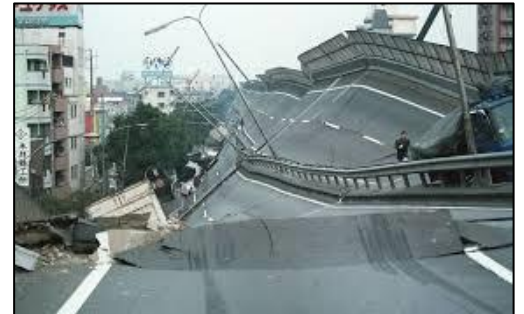
倒壊した阪神高速道路神戸線（東灘区）
